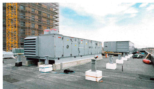
Vier Lüftungsgeräte der Baureihe AI-Ko AT4 wurden auf dem Dach des Hochhauses platziert. Sie wälzen im Holzhaus Roots pro Stunde insgesamt 42.000 m 3 Luft um.
